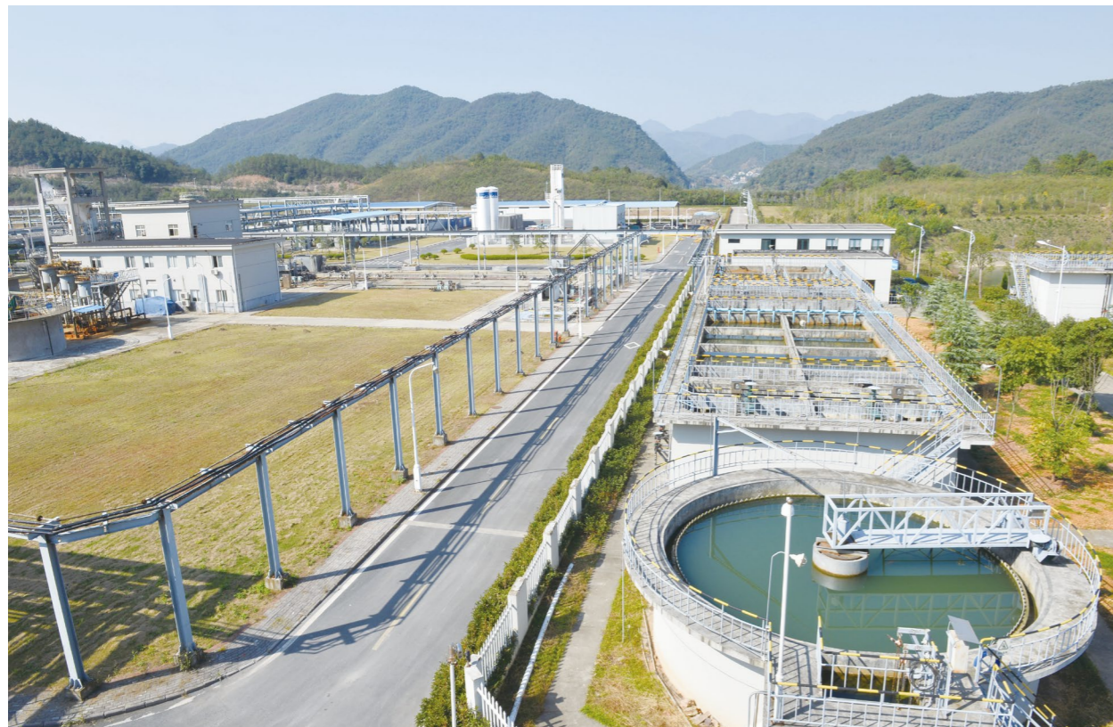
园区废水处理站
